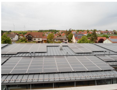
Photovoltaikanlage auf dem Schuldach (Quelle: Markt Mühlhausen)
